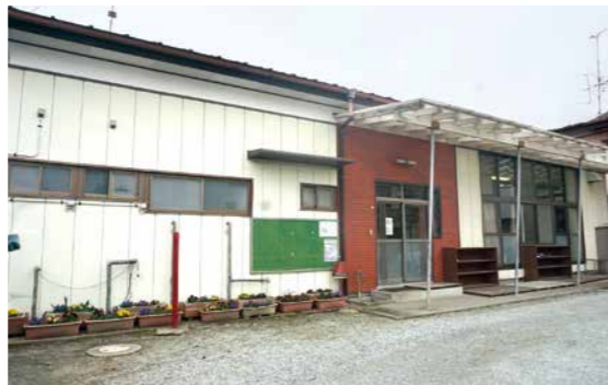
老朽化した町区老人憩いの家
